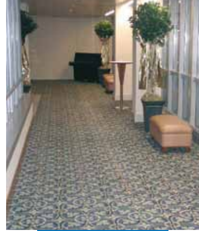
Ultraplan Eco ile tesviye edildikten sonra halı döşenmiş bir otel koridoru - Hotel Renaissance - Avusturya
